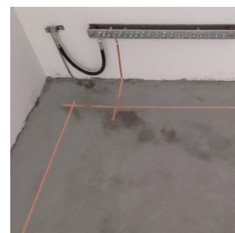
Taśma miedziana podłączona do szyny wyrównującej potencjał elektryczny (szyna uziemiająca).
