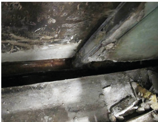
Zagrzybiona konstrukcja ściany, wykonanej z płyty gipsowo-kartonowej.
