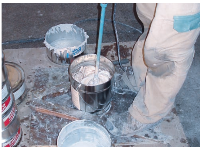
3 Staranne wymieszanie składników A i B powłoki uszczelniającej Sopro PU-FD po przełożeniu do nowego pojemnika.
