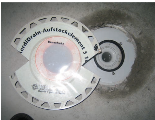
Odpływ podłogowy z szerokim kołnierzem do połączenia z uszczelnieniem został zniszczony dla ułatwienia montażu.
