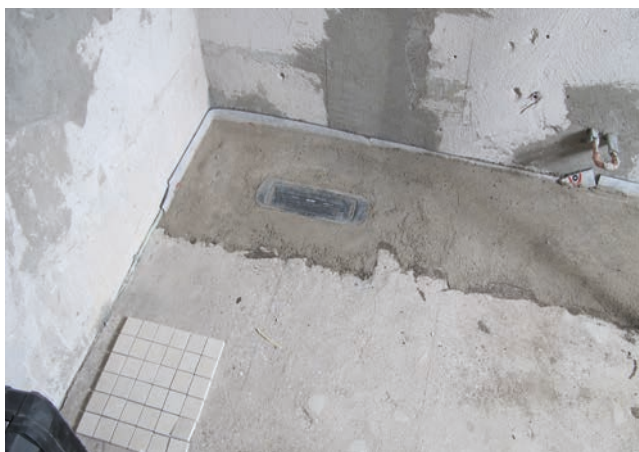
Posadzka natrysku wykonana przy użyciu zaprawy cementowej do jastrychów (Sopro Rapidur® M5).
