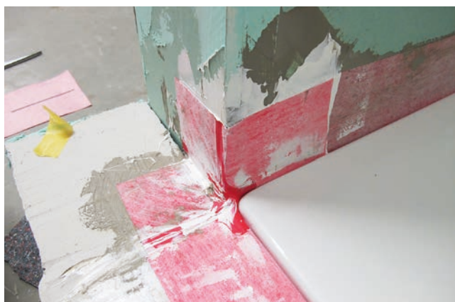
4 Zlicowanie górnej krawędzi brodzika prysznicowego z okładziną ceramiczną posadzki w obszarze narożnika ściany za pomocą dwóch zintegrowanych uszczelki narożnych multi Sopro WDM 813.
