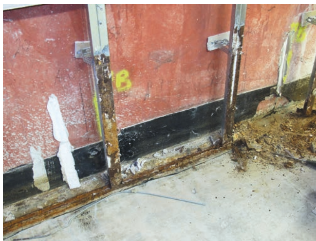
Uszkodzenie konstrukcji suchej zabudowy, spowodowane wnikającą wodą.
