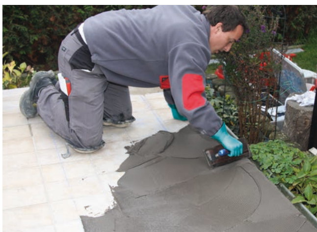
3 Nałożenie wysokoelastycznej zaprawy klejowej Sopro MEG 667 Silver pod następnie układane odcinki maty uszczelniająco-odcinającej Sopro AEB ® plus 639.
