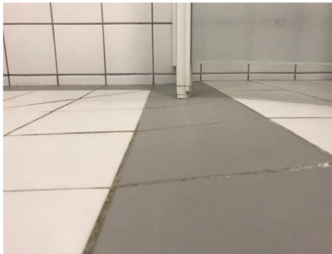
Nachylenie uformowanej płytki jest wyraźnie widoczne.
