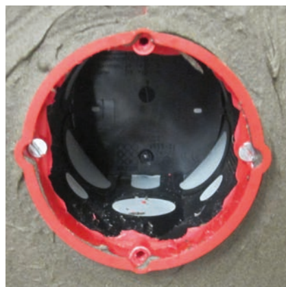
5 Uszczelniona puszka instalacyjna.
