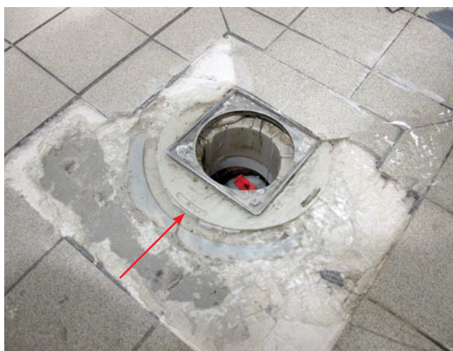
Zamontowany fabrycznie kołnierz uszczelniający został odcięty. W konsekwencji brak możliwości poprawnego wklejenia uszczelki podłogowej na zaprawie uszczelniającej.
