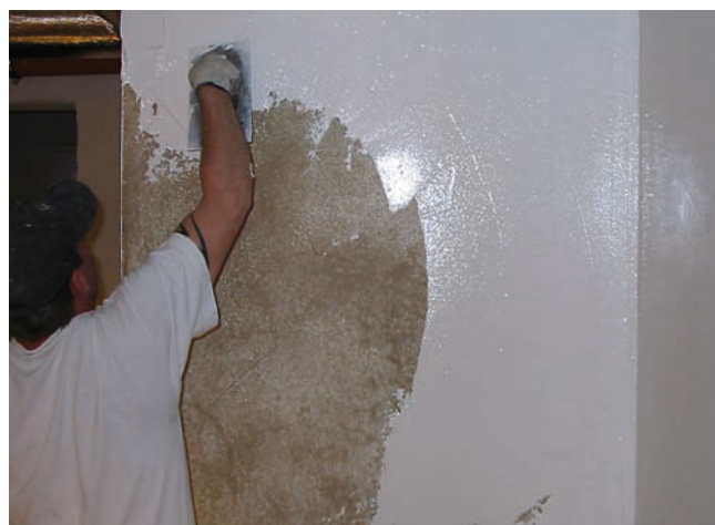
4 Nanoszenie uszczelnienia Sopro PU-FD 1570 na ścianę w dwóch warstwach o łącznej grubości powłoki min. 1 mm.
