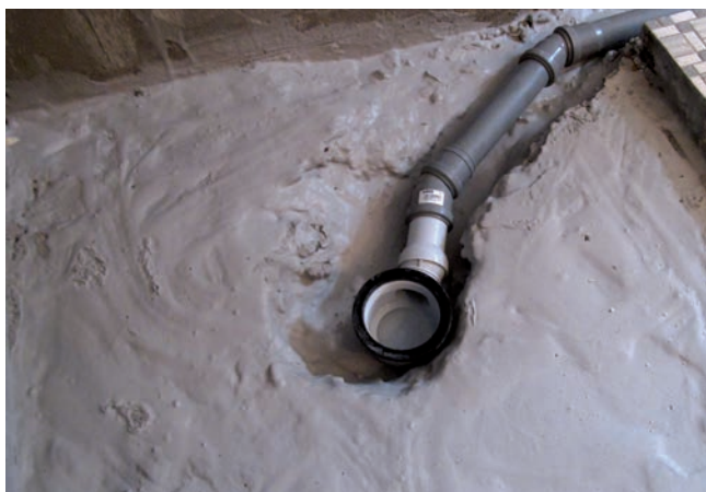
1 Zagłębienie w nierównej powierzchni jastrychu modernizowanego naroża prysznicowego.
