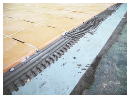
Układanie płytek wykonać na zaprawie klejowej Sopro MEG 667 Silver lub kleju epoksydowym Sopro DBE 500.
