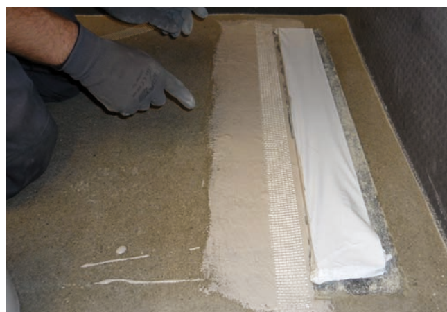
4 Uszczelnienie korpusu odwodnienia liniowego przy użyciu Sopro DSF 523. Połączenie z kolnierzem jest wykonane przez wstawienie systemowej taśmy lub paska siatki zbrojącej w uszczelnienie zespolone.
