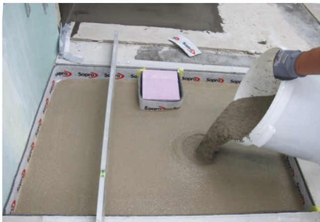
1 Wykonanie równej powierzchni z użyciem płynnego jastrychu Sopro Rapidur® FE dla montażu elementu naroża prysznicowego.
