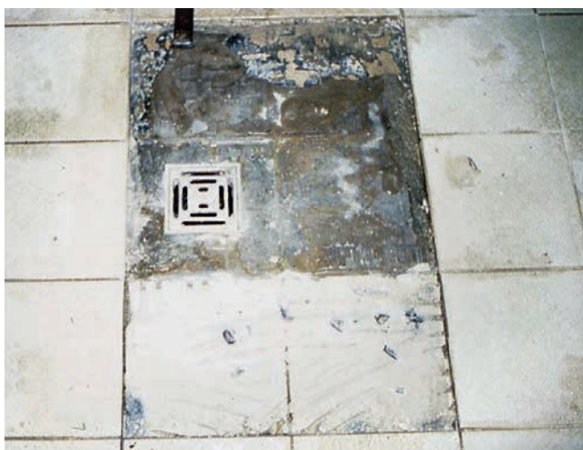
Brak uszczelnienia w okolicy wpustu podłogowego.
