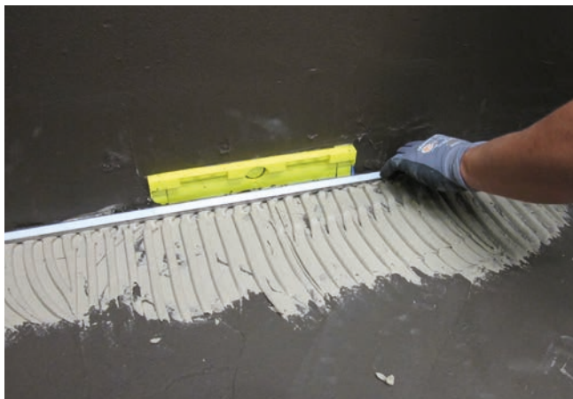
7 Jako uzupełnienie odwodnienia ściennego na uszczelnionej powierzchni wklejona jest szyna zbierająca wodę, przy użyciu zaprawy klejowej, np. Sopro No.1 400 extra.
