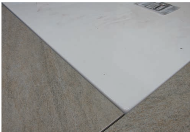
4 Wyraźnie jest widoczne zlicowanie okładziny ceramicznej z krawędzią brodzika.
