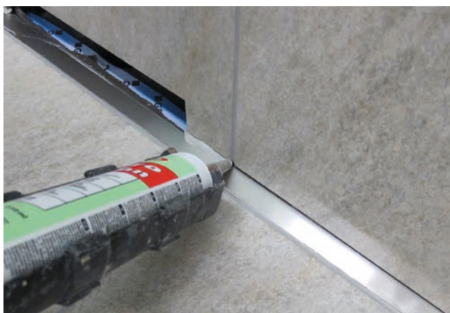
11 Odległość szyny zbierającej wodę od ściany wynosi ok. 5 mm (w przypadku jastrychu pływakącego). Szczelina łącząca ścianę z posadzką jest wypełniona trwale elastycznie silikonem Sopro Silicon.
