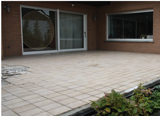
1 Stara, nośna okładzina ceramiczna na tarasie.
