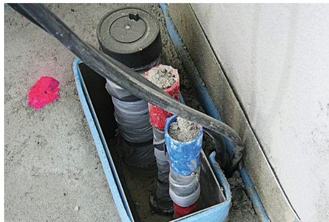
Nieprawidłowe rozwiązanie. Ze względu na utrudniony dostęp do okablowania nie jest możliwe profesjonalne wykonanie uszczelnienia.
