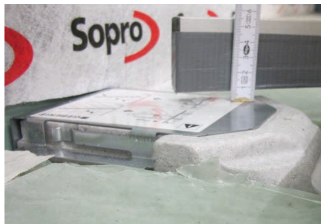
2 Niewystarczająca wysokość do zabudowy jastrychu cementowego. Konieczność zabudowy jastrychu na bazie żywic reaktywnych.
