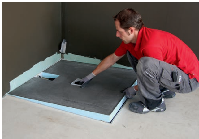
Uszczelnienie w postaci płyt ma swoje początki w strefach posadzki natrysku.
