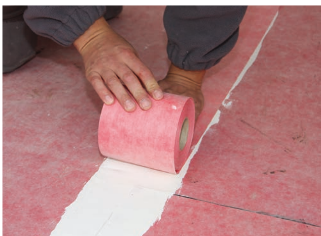
9 Uszczelnienie obszaru styku mat przy pomocy taśmy uszczelniającej Sopro AEB® 148. Alternatywnie wodoszczelne klejenie taśmy może nastąpić z zastosowaniem zaprawy uszczelniającej Sopro TDS 823.
