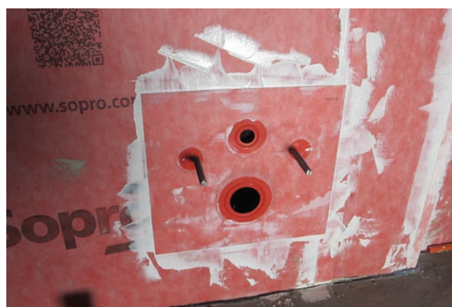
Uszczelka Sopro AEB® 1174 prawidłowo przyklejona, montaż miski ustępowej może nastąpić po ułożeniu płytek.
