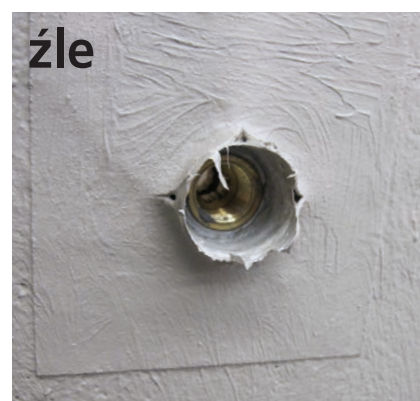
Po odkręceniu korka do zamontowania instalacji, uszczelka całkowicie utraciła właściwości uszczelniające.
