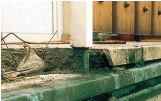
Jastrych, który utracił wytrzymałość z powodu stałego wnikania wody.
