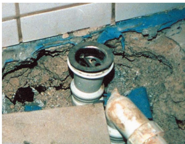
Nieszczelność powstała na skutek braku możliwości uszczelnienia, brak kołnierza odpływu podłogowego.
