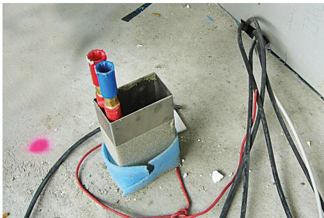
Nieprawidłowe rozwiązanie. Okablowanie wychodzi z jastrychu w przypadkowy sposób.
