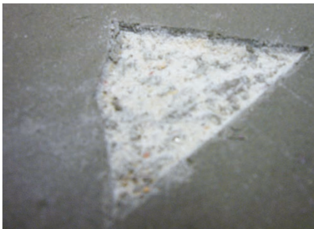
Miejsce po wycięciu próbki uszczelnienia.
