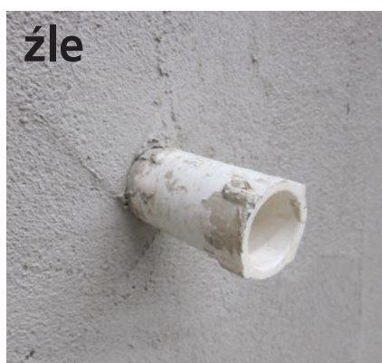
Otynkowane wyjście rury, którego nie można fachowo uszczelnić.
