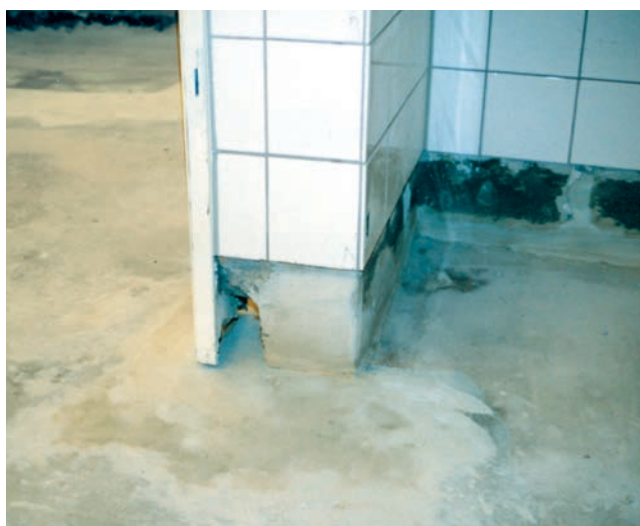
Otwór wycięty w ścianie w okolicy ościeżnicy.
