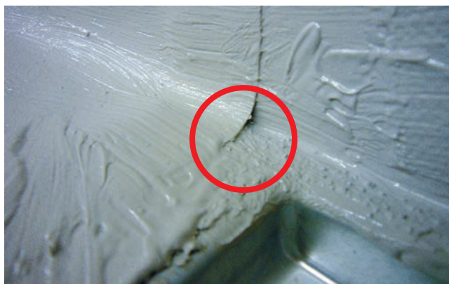
Widoczna nieszczelność w narożu.
