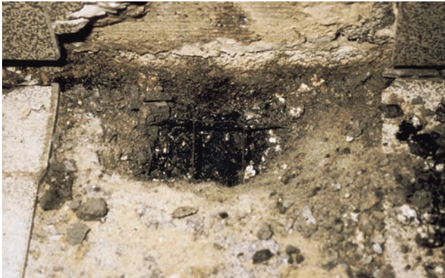
Zawilgocony jastrych z powodu braku uszczelnienia zespolonego – problem higieniczny, np. w kuchniach zbiorowego żywienia.
