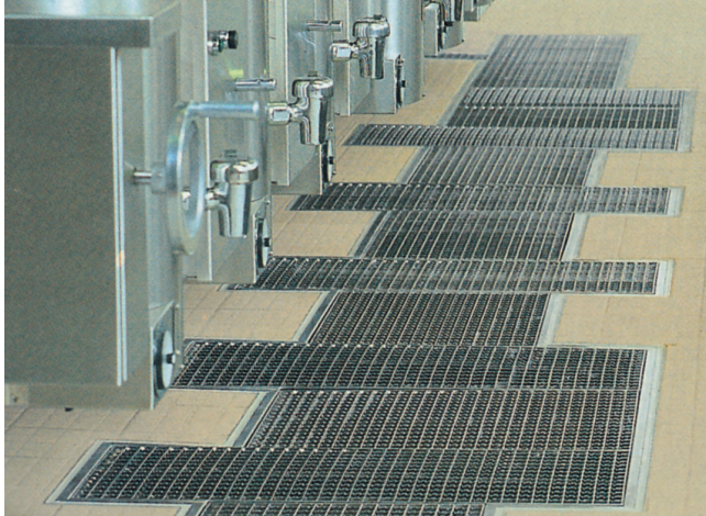
Duże obciążenia mechaniczne i chemiczne fugowanych powierzchni przemysłowych (przemysł przetwórstwa żywności).
