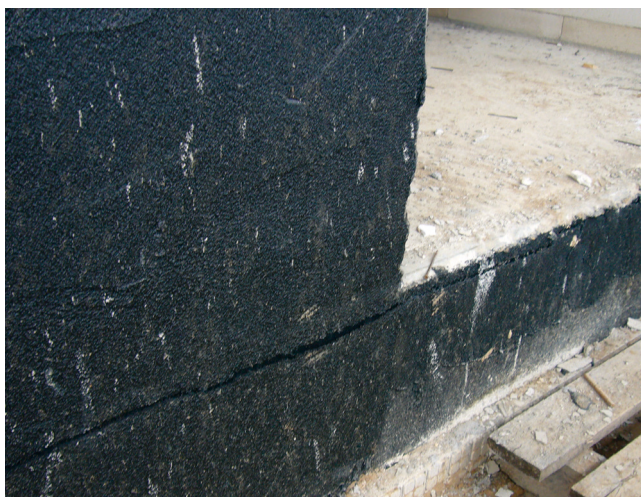
Uszkodzenie (rozerwanie) powłoki bitumicznej na skutek osiadania gruntu i braku właściwej warstwy ochronnej z folią poślizgową.
