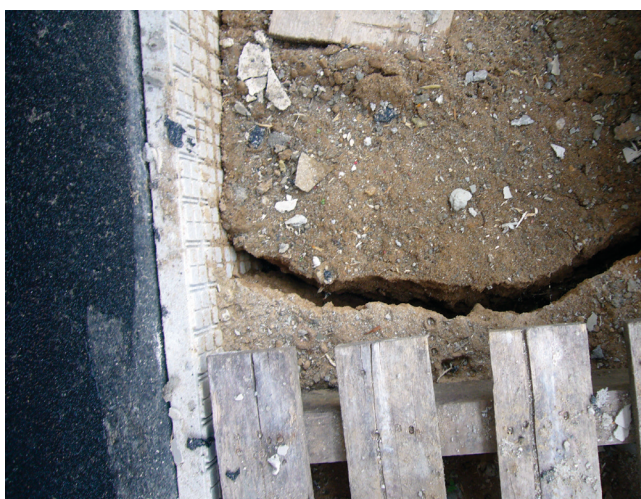
Zwiększone osiadanie gruntu w efekcie niewystarczającego zagęszczenia w zasypywanym wykopie wokół budynku. Brak warstwy poślizgowej prowadzi do uszkodzenia uszczelnienia bitumicznego.
