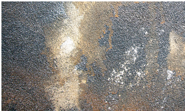
Stare, odsłonięte uszczelnienie piwnicy.
