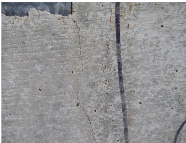
Pęknięcia powstałe w uszczelnionej ścianie.
