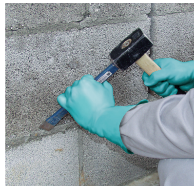
2 Wystające resztki zaprawy ściąg, ostre krawędzie szlifować. Usunąć mleczko cementowe.
