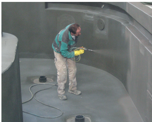
Uszczelnienie niecki basenowej metodą natryskową z zastosowaniem cementowej, elastycznej zaprawy uszczelniającej, np. Sopro DSF® 423.
