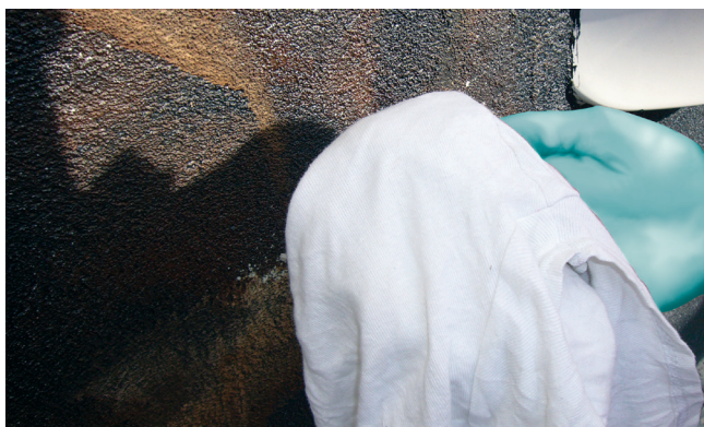
Brak zabrudzenia: próba nie wykazała rozpuszczenia się starej powłoki. Z dużym prawdopodobieństwem jest to powłoka smołowa.
