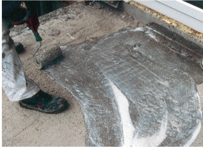
Podłóżę przygotowywane pod wylewkę samopoziomującą, wysokowytrzymałą Sopro HF-S, nanoszenie metodą „mokre na mokre” tj. na świeżą warstwę emulsji szpelenj Sopro HE 449.
