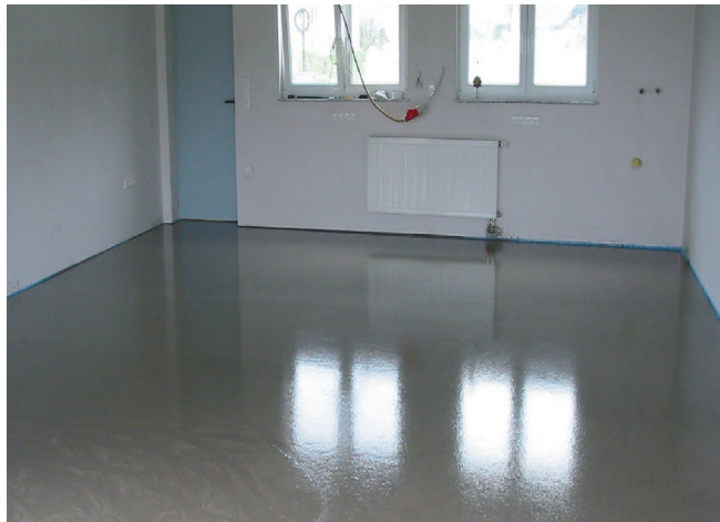
Gotowa do użytkowania powierzchnia wykonana z masy samopoziomującej Sopro HF-S, po związaniu jest gładka, równa, odporna na ścieranie.
