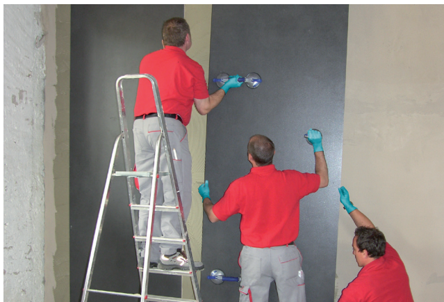
Osadzenie płyty wielkoformatowej na ścianie z zastosowaniem zaprawy klejowej Sopro MG-Flex ® XXL 679.
