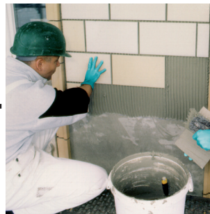
Metoda kombinowana – nałożenie warstwy kontaktowej na spód płyty i ułożenie jej na przygotowaną warstwę grzebieniową na podłożu.
