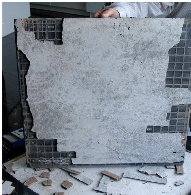
Odspojenie okładziny wraz z warstwą osłabionego jastrychu anhydrytowego spowodowane wilgocią z zaprawy klejowej.
