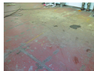
Posadzka stalowa ze spawami, którą należy wyrównać przed układaniem płytek.
