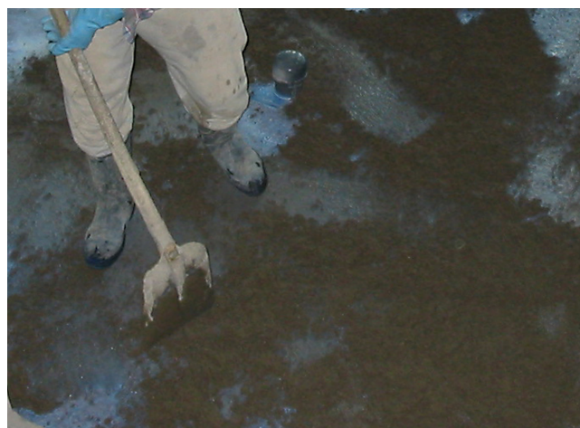
Wykonywanie jastrychu zespolonego: praca metodą „mokre na mokre” tj. wykładanie zaprawy jastrychowej na świeżą zaprawę szczepną.
