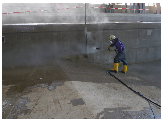
Piaskowanie powierzchni betonu w celu uzyskania podłoża o optymalnej przyczepności, pod kolejne warstwy wykończeniowe.
