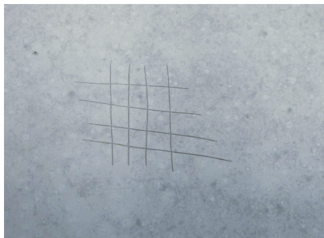
Po zeszlifowaniu widoczne są tylko ostre zarysowania. Powierzchnia optymalnie została przygotowana do układania.
