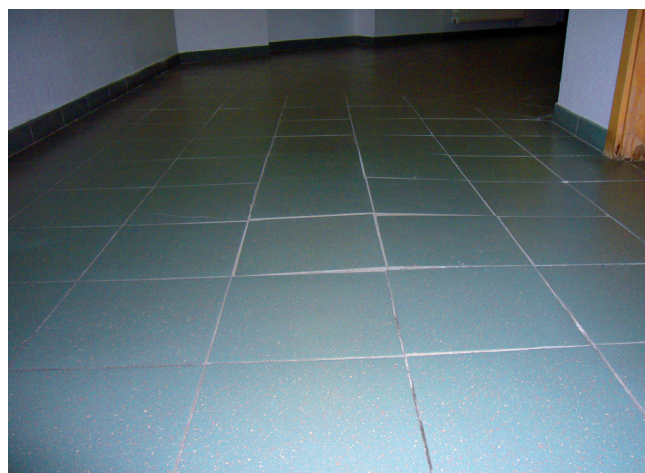
Spuchnięty jastrych anhydrytowy po zalaniu wodą.
