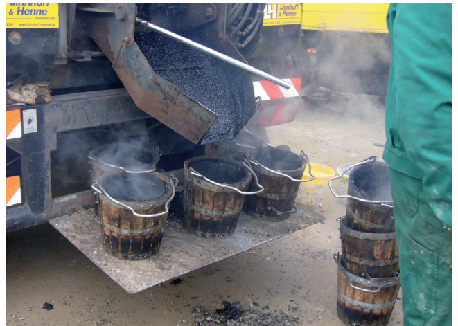
Gorący jastrych z lanego asfaltu sprowadzany jest na miejsce budowy i wbudowywany.
