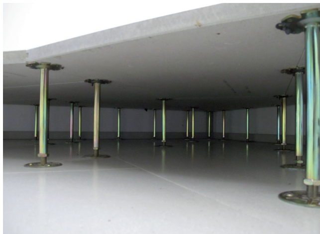
Konstrukcje podłóg podniesionych mogą być wykonane na podporach o różnej wysokości (w zależności od instalacji technicznych).
