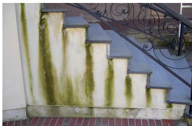
Woda wypływająca na boczne powierzchnie schodów powoduje uszkodzenia i nieestetyczne zabrudzenia.
