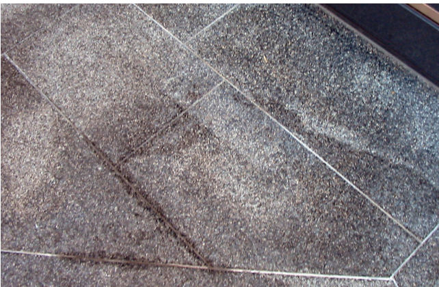
Przebarwienia na okładzinie kamiennej, powstałe w obszarze zewnętrznym, na skutek przenikania wilgoci przez fugę.
