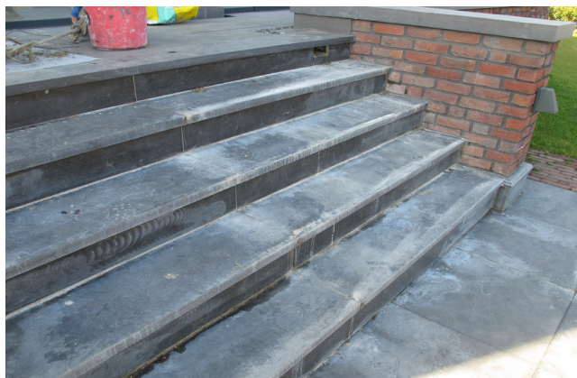
Powierzchnia tarasu odwadniana przez bieg schodów. W rezultacie powstają zabrudzenia i przebarwienia.
