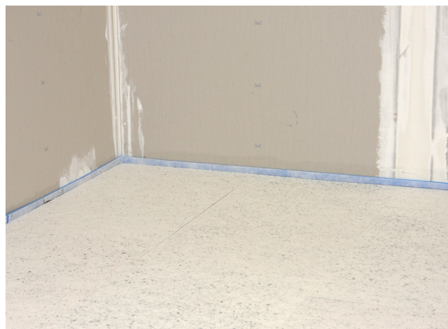
14 Oddzielona przy pomocy płyt kompensacyjnych Sopro FDP 558 powierzchnia podłogi drewnianej została przygotowana do układania okładziny ceramicznej.
