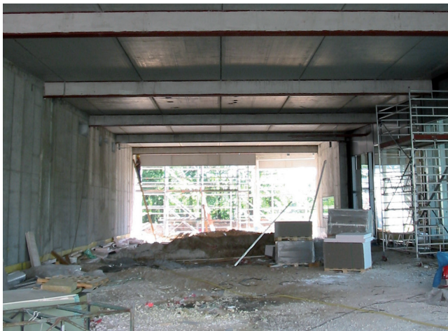
Sprężona płyta betonowa z wygięciem, która się odpręża i obniża w punkcie środkowym o 2-4 cm.
