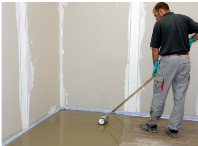
8 Wylewkę Sopro FLOOR WS 3.70 extreme rozprowadzić i odpowietrzyć przy pomocy walca z kolcami, aby uzyskać równą powierzchnię podłoża.
