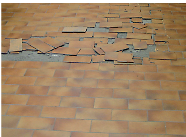
Odpadanie płytek na skutek ułożenia okładziny na niewysezonowanym podłożu betonowym.
