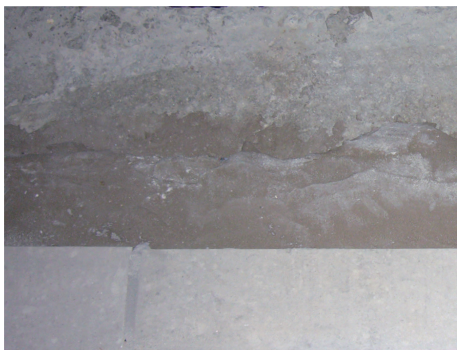
Mostek akustyczny, spowodowany przez zaprawę klejową.
