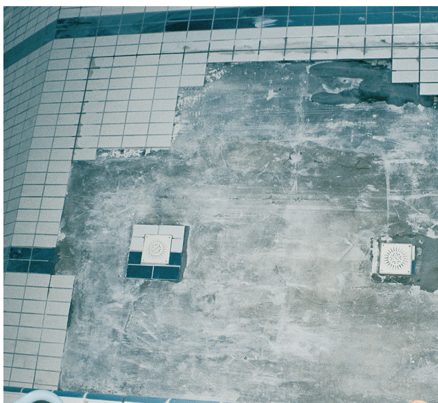
Utrata przyczepności spowodowana zbyt cinną warstwą uszczelnienia.
