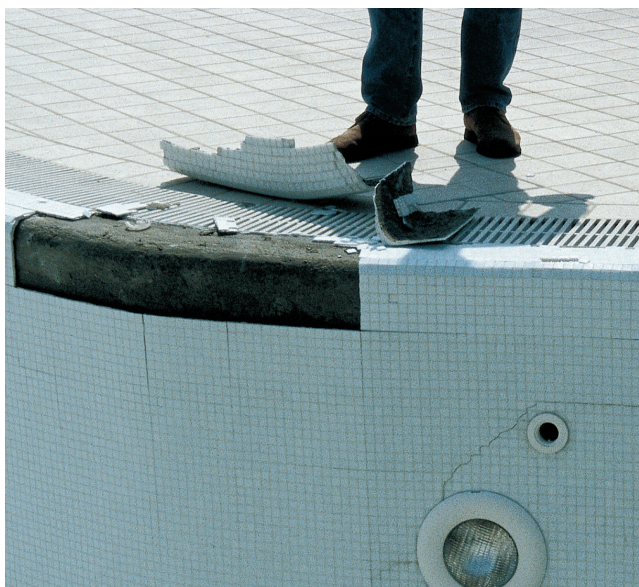
Utrata przyczepności w obszarze reflektora.
