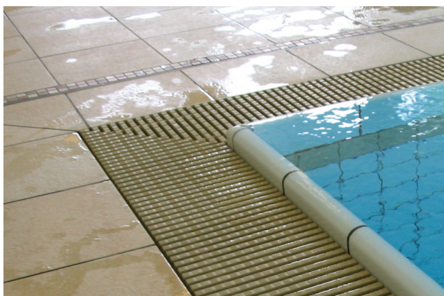
Wysokie lustro wody przy rynnie przelewowej w systemie „Wiesbaden”, które znajduje się ok. 3-4 cm powyżej poziomu powierzchni okołobasenowej.
