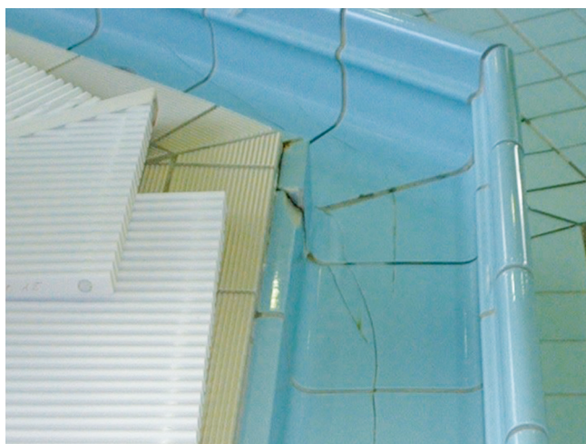
Popękane kształtki rynny przelewowej w narożu wewnętrznym z powodu naprężeń ścinających.
