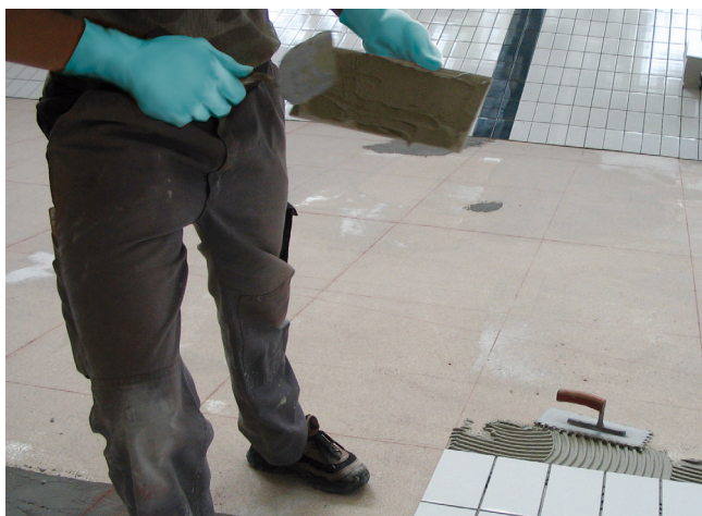
3 Po wykonanej próbie wodnej klejenie płytek wysokoelastyczną zaprawą klejową Sopro No.1 400 extra, metodą kombinowaną.
