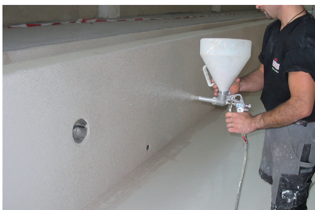
10 Wykonanie posypki z piasku kwarcowego Sopro QS 511 na świeżej powierzchni uszczelnienia Sopro PU-FD 1570 przy pomocy pistoletu natryskowego
