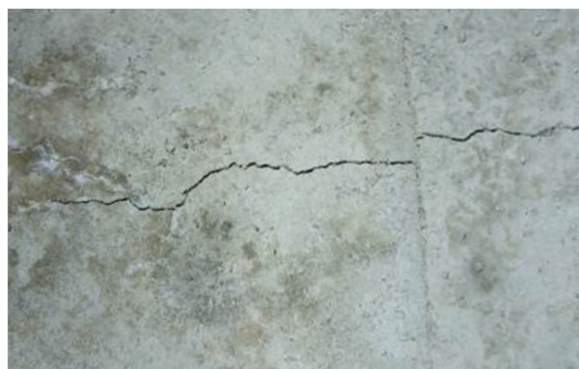
Rysy w betonie muszą być zinwentaryzowane, sklasyfikowane i przed rozpoczęciem dalszych prac odpowiednio naprawione.
