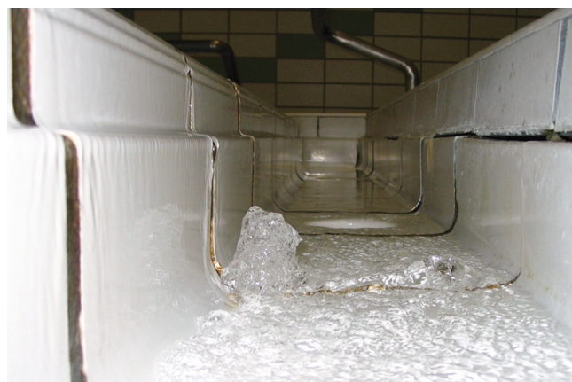
Porowata zaprawa fugowa; woda pod działaniem ciśnienia znajduje ujście przez dno rynny przelewowej.
