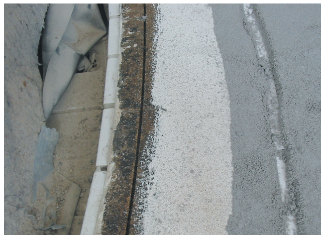
Bruzda nacięta w betonowej główce niecki basenowej.
