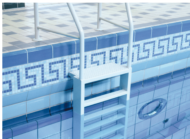
Niskie lustro wody w zabytkowym obiekcie basenowym.
