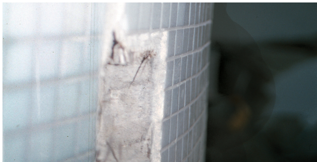
Deformacja okładziny z powodu przesuniętej rynny.
