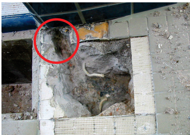
Niekontrolowany przepływ wody na zakończeniu rynny na powierzchni okołobasenowej.
