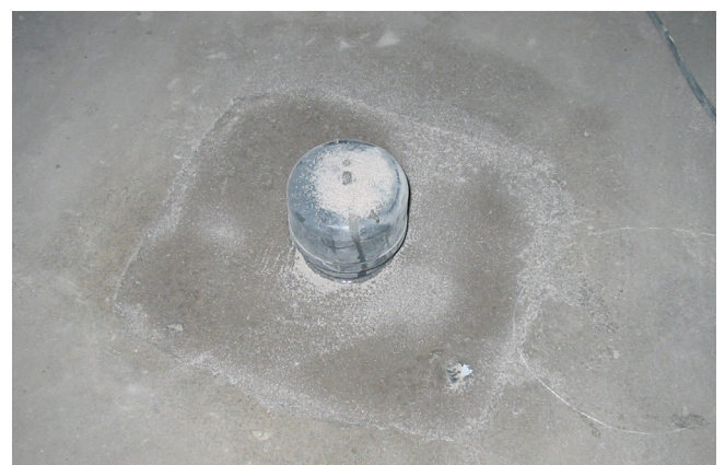
Przepust podłogowy, wypełniony antykapilarną mieszanką żywicy epoksydowej Sopro EPG 1522 i piasku kwarcowego Sopro QS.
