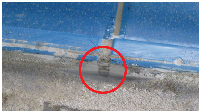
Wypływ wody przez spoinę rynny przelewowej.
