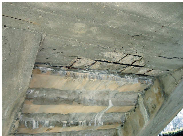
Uszkodzenia spowodowane korozją na spodniej stronie konstrukcji schodów, powstałe na skutek braku uszczelnienia i zbyt cienkiej warstwy betonu, pokrywającego zbrojenie.
