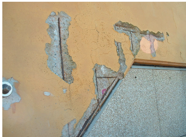
Wykruszenia w fasadzie betonowej powstałe na skutek pokrycia zbrojenia zbyt cienką warstwą betonu.
