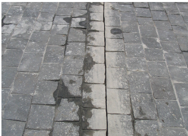
Nacięcie dylatacji w nawierzchni drogowej kilka dni po ułożeniu bruku i zaspoinowaniu.
